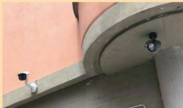
Videosorveglianza installata presso il palazzo comunale
